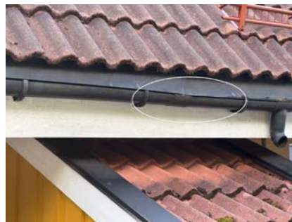
Takrenne har en svanke.
