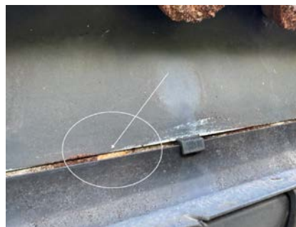
Manglende dekning mellom bordtaksbeslag og takrenne.
