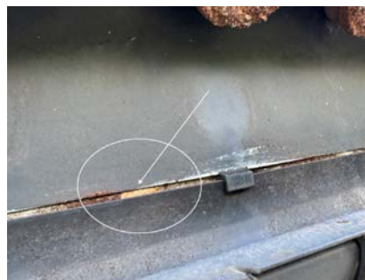
Manglende dekning mellom bordtaksbeslag og takrenne.
