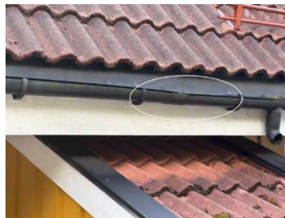
Takrenne har en svanke.
