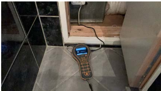
Fuktmåling i hulrom i veggen bak badekaret.
