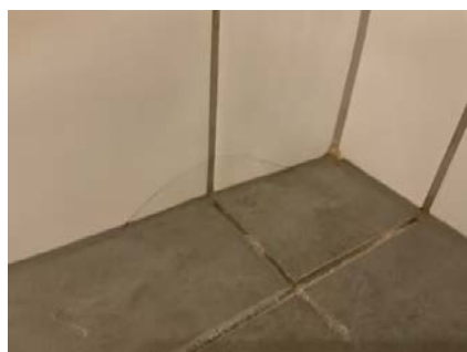
2 stk. sprukket flis på vegg i dusj.
