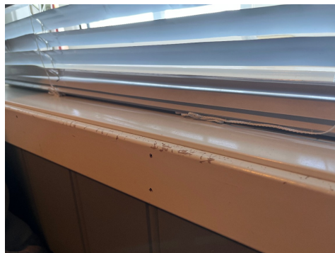
Slitasje på lister og foringer.
