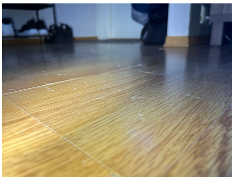
Slitasje på laminatgulv.
