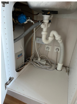
Varmtvannsbereder i kjøkkenbenk.
