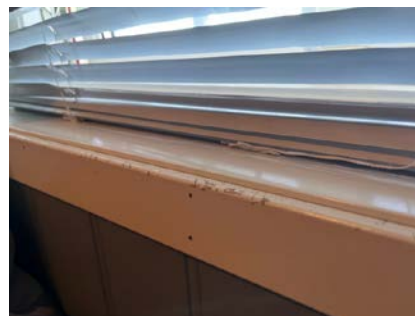
Slitasje på lister og foringer.
