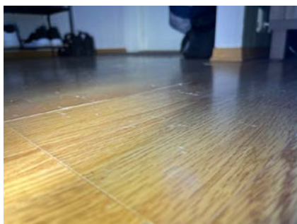
Slitasje på laminatgulv.
