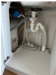
Varmtvannsbereder i kjøkkenbenk.
