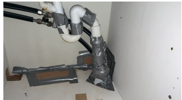
Mye tape rundt avløpsrør på kjøkken.
