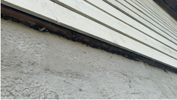
Det er ikke lufting i underkant av kledning.
