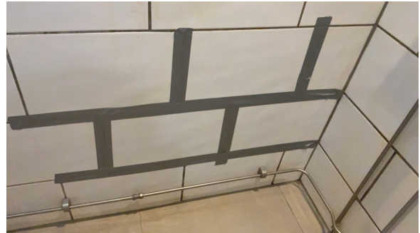
Det er tapet over sprekker i fuger.
