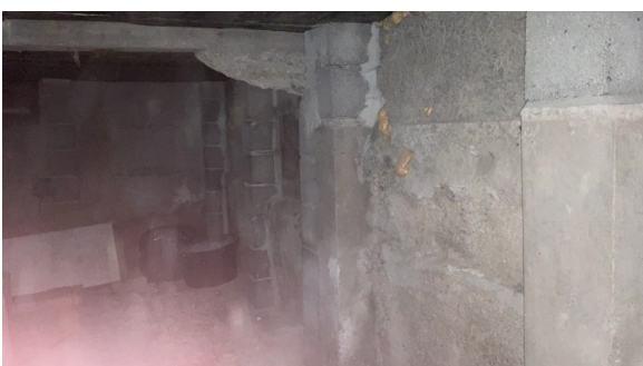
Sprekk og skjevheter på grunnmur.
