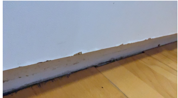
Eksempel på slitasje.
