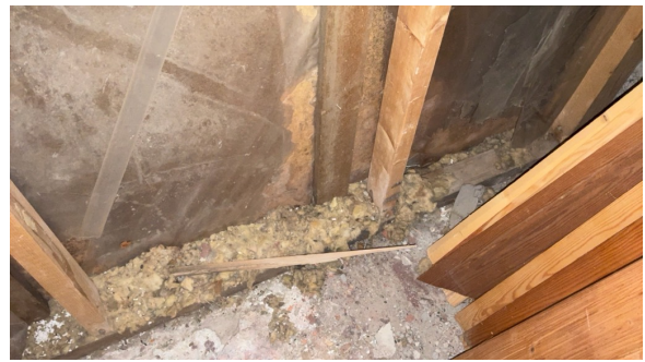
Det er noe fuktmerker på baksiden av plater.
