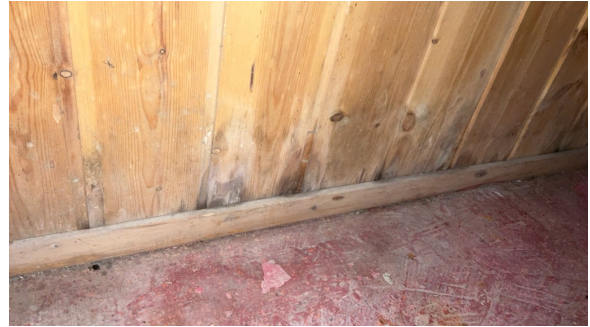
Det er flere steder synlige fuktpåkjenninger på utforede vegger mot terreng.
