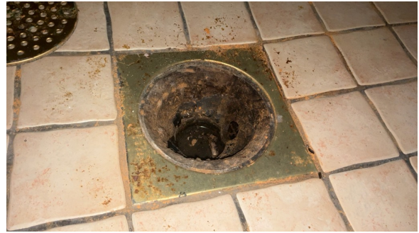
Sluk av plast, det er ikke tegn til membran på gulv.
