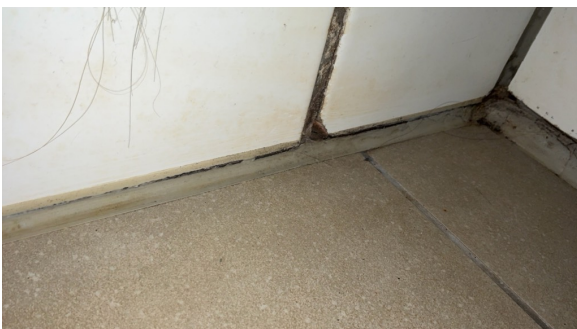
Det sprekker opp mellom gulv og vegg.
