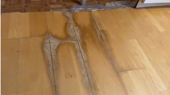
Slitasje og fuktskader på gulv på kjøkken.
