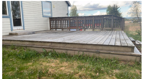
Skjevheter på konstruksjonen.
