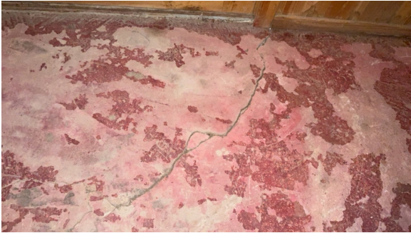
Avskaling av maling og sprekker i betonggulv.
