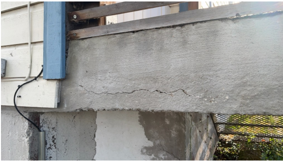
Sprekk i side på dekkkant
