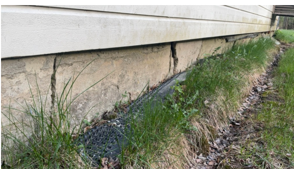
Sprekk og skjevheter på grunnmur.
