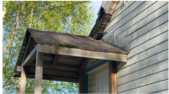
Utett overgang mellom tak og vegg.
