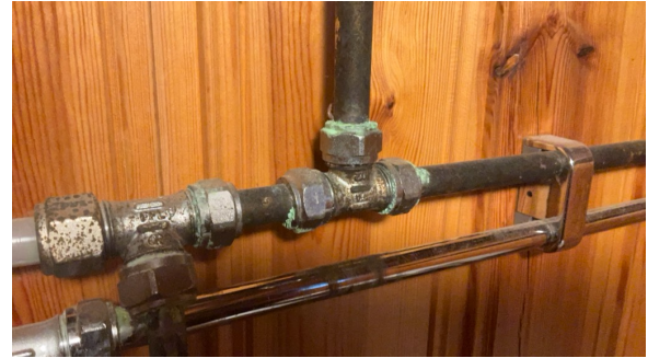
Eksempel på korrosjon.
