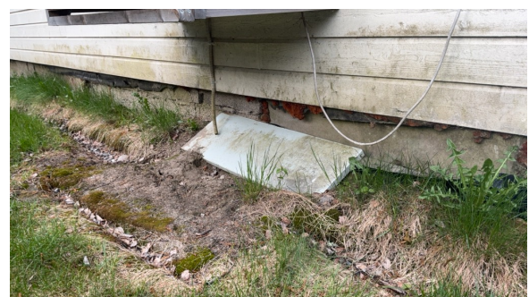
Sprekk og skjevheter på grunnmur.
