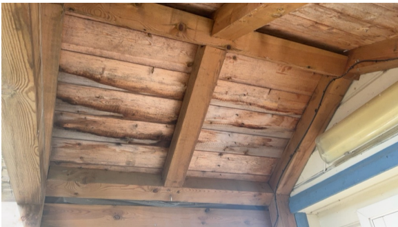
Svertesopp og fuktmerker i himling.
