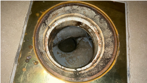
To sluk av plast i rommet.
