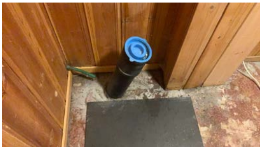
Det kommer opp stikk i kjeller, ukjent hva dette er
