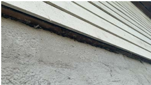
Det er ikke lufting i underkant av kledning.
