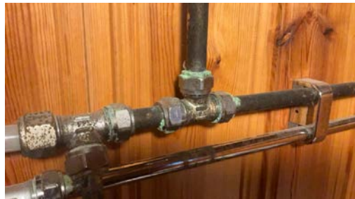
Eksempel på korrosjon.
