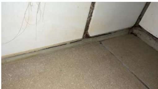
Det sprekker opp mellom gulv og vegg.
