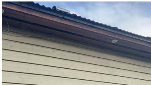
Det er ikke takrenner og beslag
