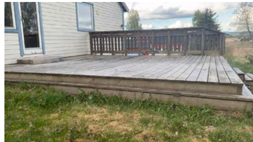
Skjevheter på konstruksjonen.
