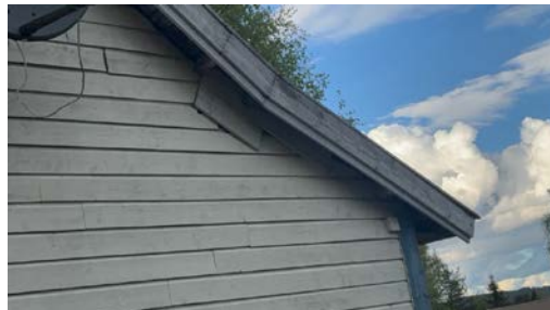
Stedvis enkle og manglende tilslutninger.
