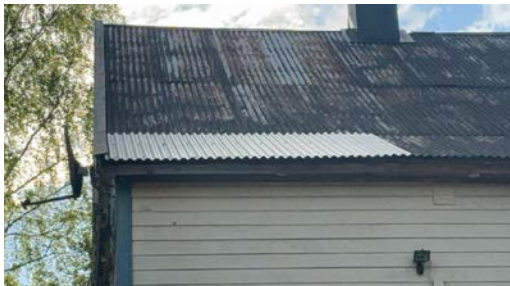
Det har vært gjort utskifting ifm. lekkasje.
