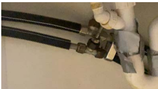
Det er ikke forsegling mellom vannrør og varerør på kjøkken.
