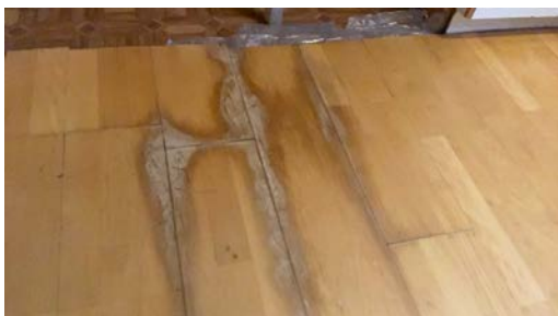
Slitasje og fuktskader på gulv på kjøkken.
