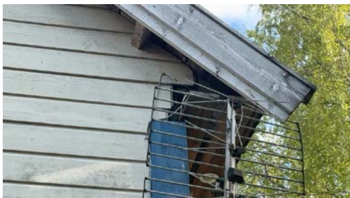
Eksempel på uferdig overgang
