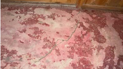
Avskaling av maling og sprekker i betonggulv.
