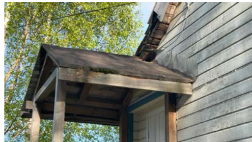
Uttett overgang mellom tak og vegg.
