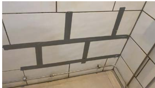
Det er tapet over sprekker i fuger.
