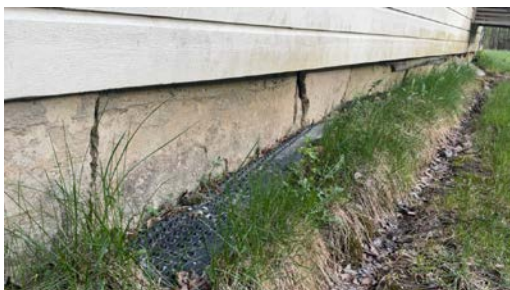
Sprekk og skjevheter på grunnmur.
