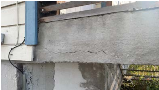
Sprekk i side på dekkekant
