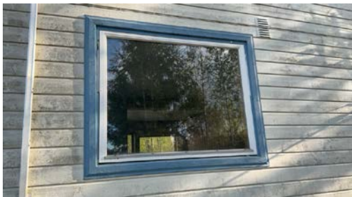
Vinduer har omramminger i stedet for vannbrettbeslag.
