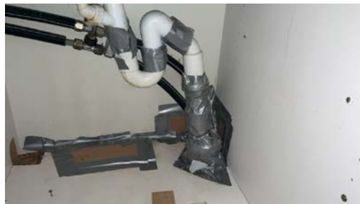
Mye tape rundt avløpsrør på kjøkken.
