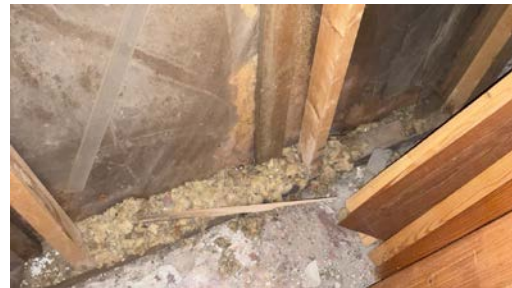
Det er noe fuktmerker på baksiden av plater.
