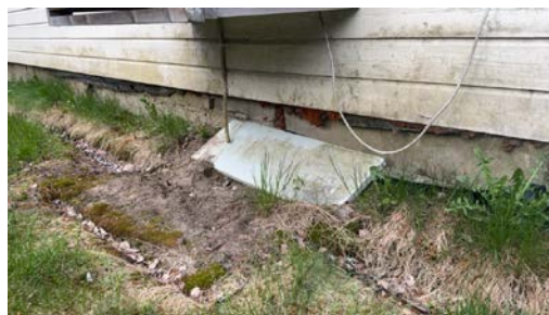
Sprekk og skjevheter på grunnmur.
