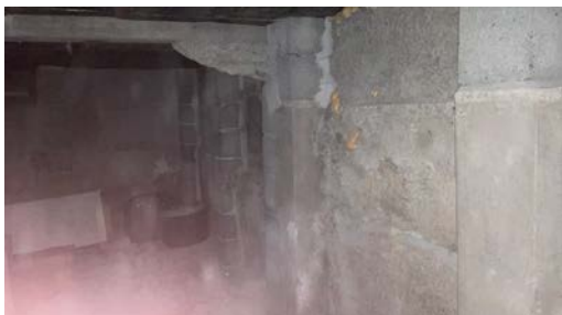
Sprekk og skjevheter på grunnmur.
