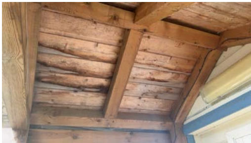
Svertesopp og fuktmerker i himling.
