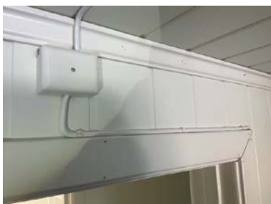
Ufagmessig utført arbeid.
