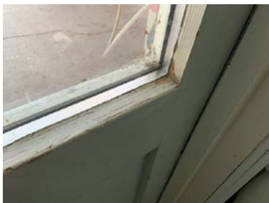
Kondensering på dør.
