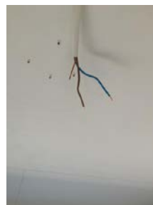
Usikre spenningsatte ledninger.
