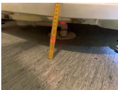
Begrenset mulighet for inspeksjon og rengjøring.
