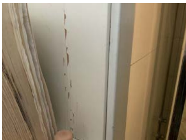
Tegn til kondensering rundt vindu på bad.
