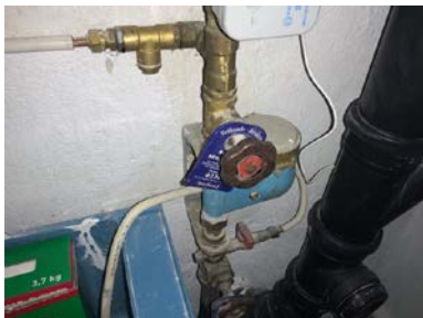
Stoppekran plassert i kjeller.
