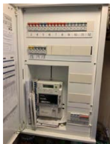
Sikringsskap plassert i kjellertrapp.
