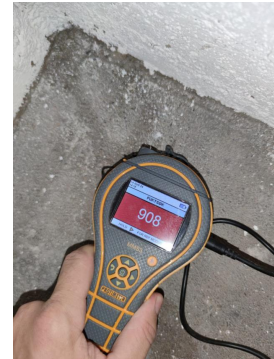
Indikert høye fuktverdier i gulv.
