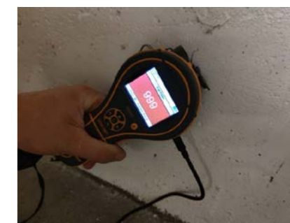
Indikert høye fuktverdier i vegg.
