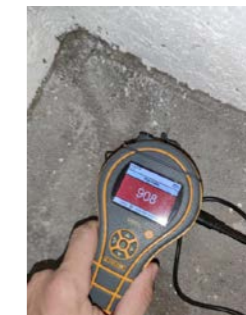
Indikert høye fuktverdier i gulv.
