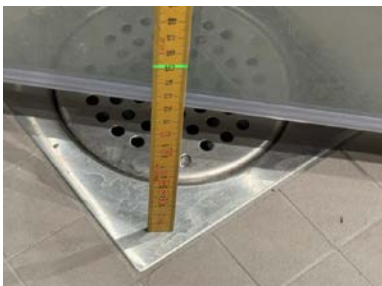
Fallforhold ca. 152 mm topp slukrist i dusjsone
