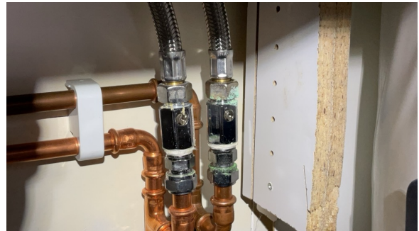
Korrodering på kobling.
