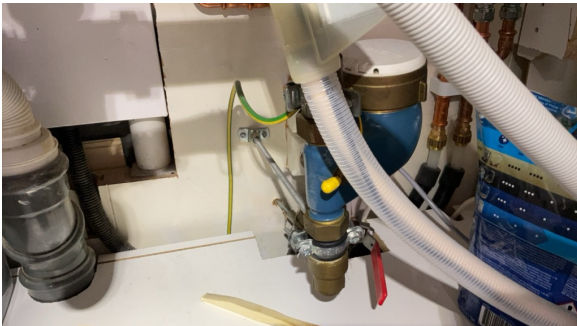
Stoppekran plassert i kjøkkenbenk.
