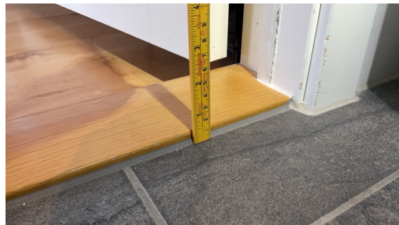
Ingen synlig oppbrett av membran ved terskel.
