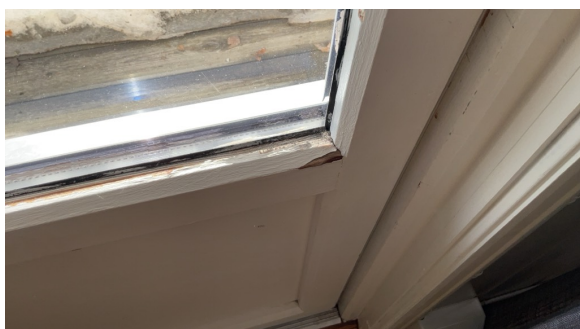
Kondensmerker på terrassedør.
