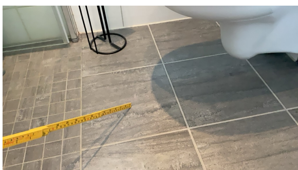
Bom/hulldyd på flis ved toalett.
