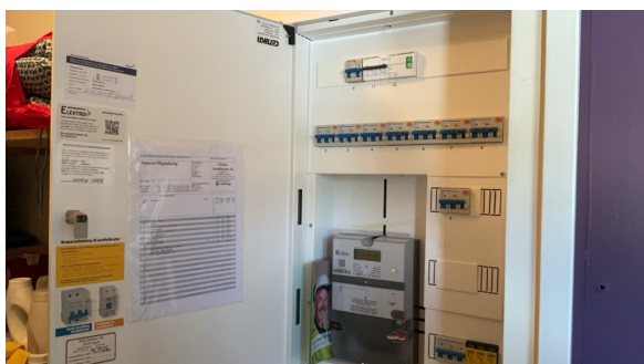
Sikringsskap plassert på bod.
