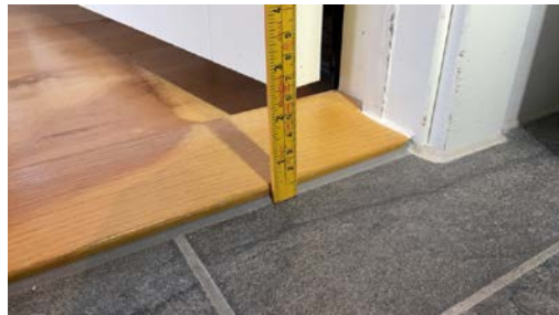
Ingen synlig oppbrett av membran ved terskel.
