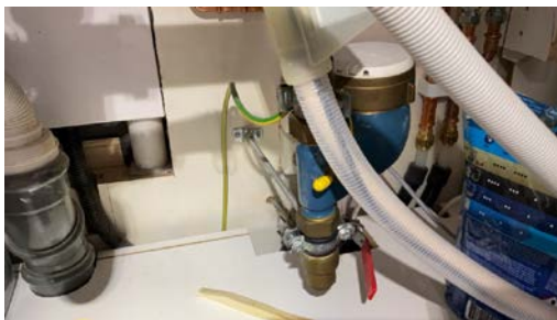
Stoppekran plassert i kjøkkenbenk.
