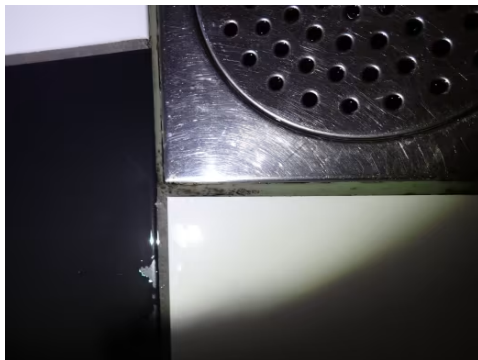
Misfarget og sprukket silikon
