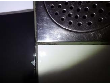
Misfarget og sprukket silikon
