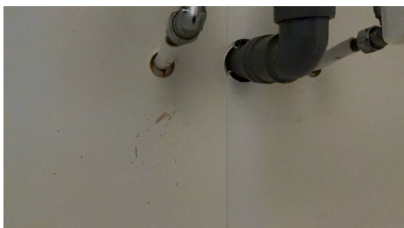
Mangelfull/feil utførelse rundt rørgjennomføringer i baderomsinnredning
