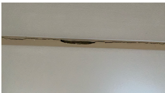
verflateskade i taket ved en elementskjøt.
