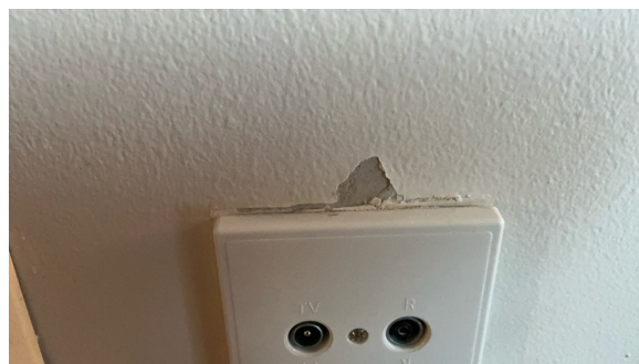
Overflateskade på vegg
