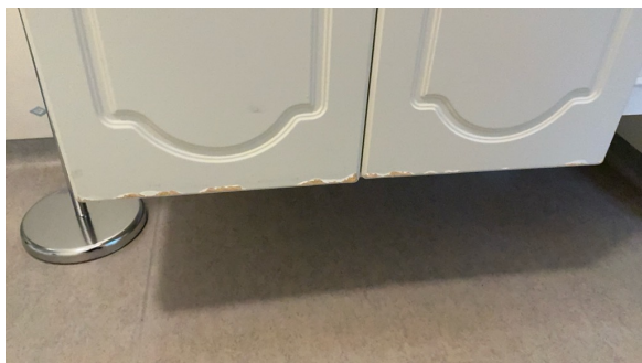
Skade/svelling på baderomsinnredning
