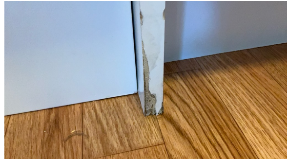
Skade på dekkside ved oppvaskmaskin
