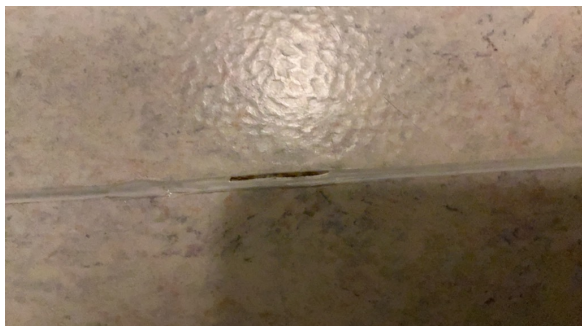
Oppsprekking i sveiseskjøtene
