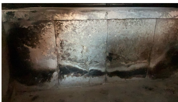
Sprekker i ildfast stein inne i ovnen
