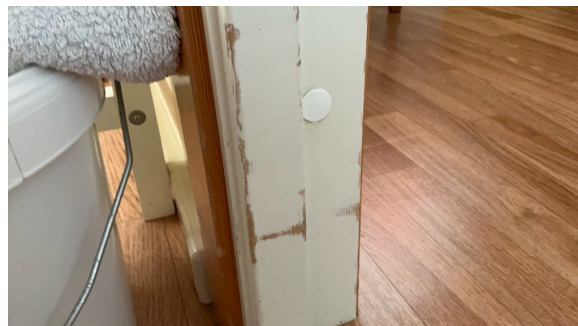
Skader i dørkarm
