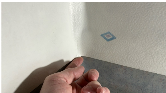
Løst i hjørne av dusjen
