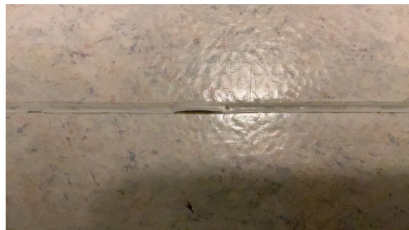
Oppsprekking i sveiseskjøtene
