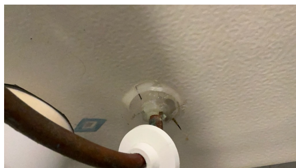
Mangelfull/feil utførelse rundt rørgjennomføringer ved toalett
