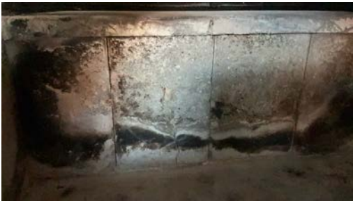
Sprekker i ildfast stein inne i ovnen
