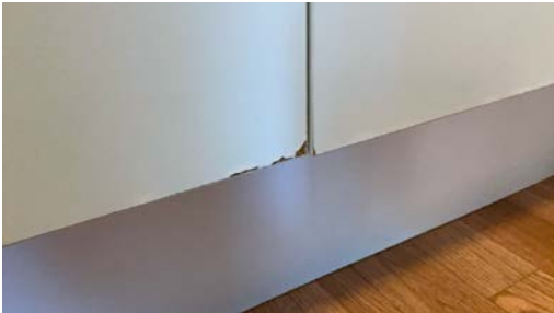
Skade på skapdør
