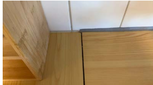
Klaring mellom benkeplater, samt feil farge på silikon mellom benkeplate og vegg.
