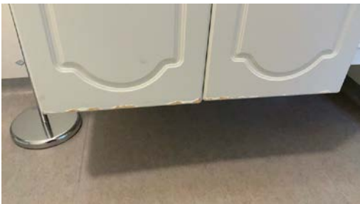
Skade/svelling på baderomsinnredning
