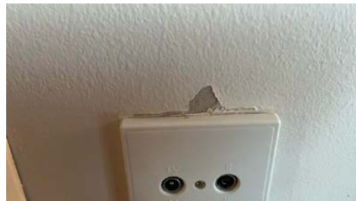
Overflateskade på vegg
