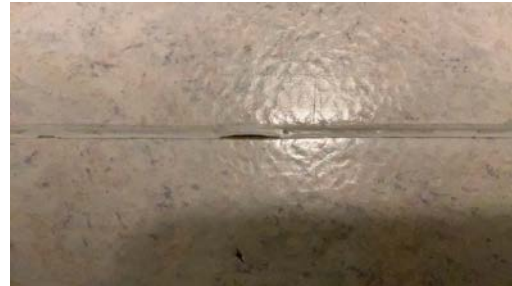
Oppsprekking i sveiseskjøtene
