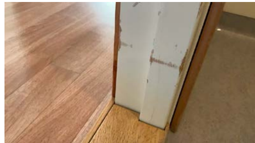
Skader i dørkarm
