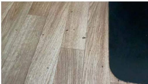
Svimerker i gulvbelegg
