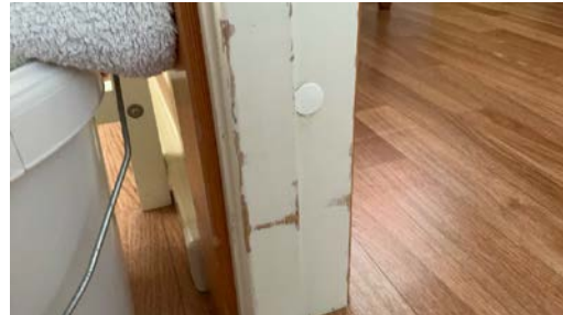
Skader i dørkarm
