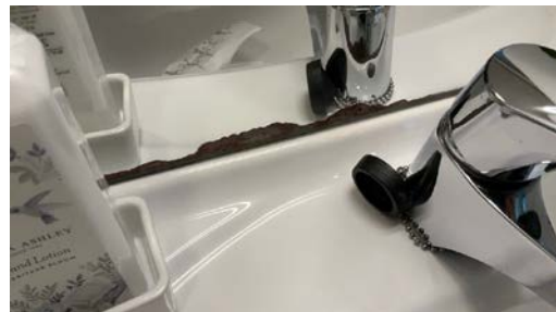
Fuktskade/misfarging i nedkant av speilet
