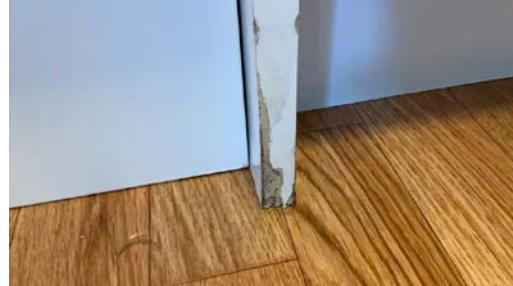
Skade på dekkside ved oppvaskmaskin
