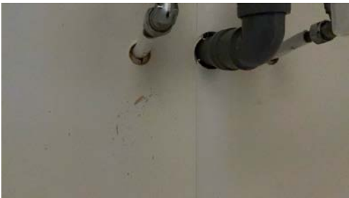
Mangelfull/feil utførelse rundt rørgjennomføringer i baderomsinnredning
