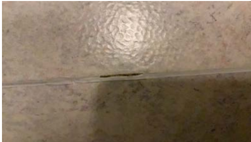
Oppsprekking i sveiseskjøtene
