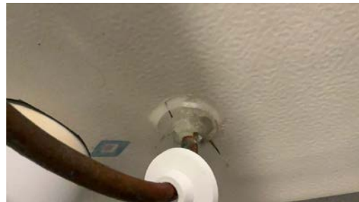
Mangelfull/feil utførelse rundt rørgjennomføringer ved toalett
