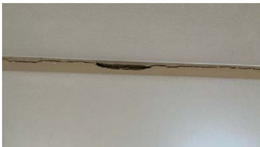
verflateskade i taket ved en elementskjøt.
