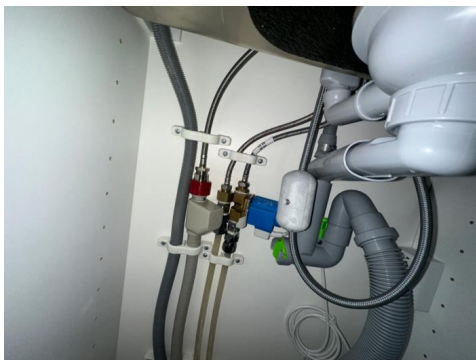
Røropplegg i kjøkkenbenk
