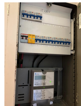
Sikringsskap med automatsikringer.
