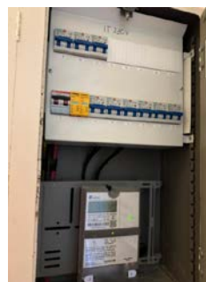
Sikringskapp med automatsikringer.
