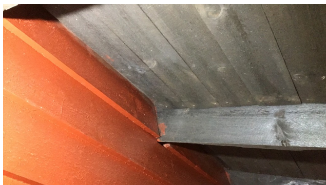
Mangler luftespalte mellom yttertak og kledning
