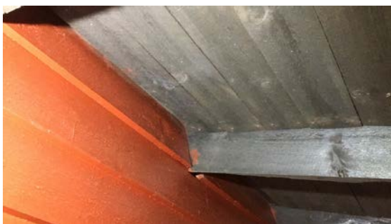
Mangler luftespalte mellom yttertak og kledning
