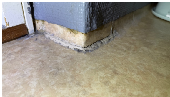
Eksempelbilde av slitt fuge i ytterhjørne.
