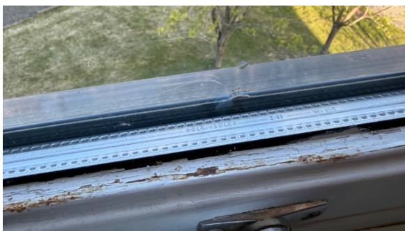
Eksempelbilde av slitasjegrad/ malingsavlass.
