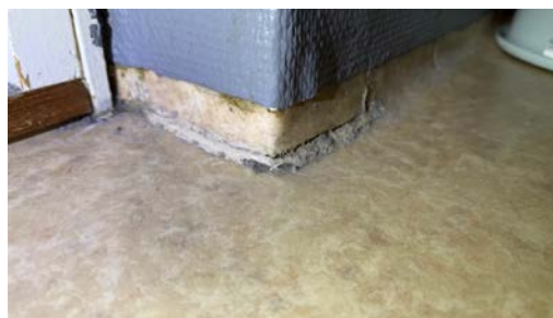
Eksempelbilde av slitt fuge i ytterhjørne.
