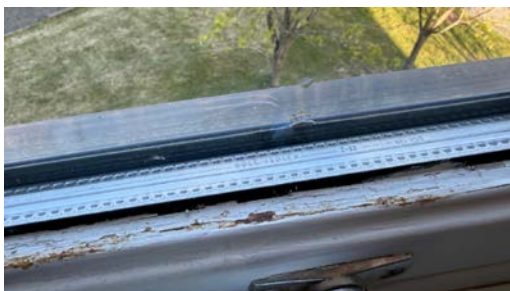
Eksempelbilde av slitasjegrad/ malingsavfluss.
