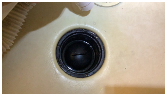
Plastsluk under dusjkabinett, og vinylbelegg er ført under slukets klemring.
