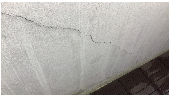
Skråriss i forstøtningsmur.
