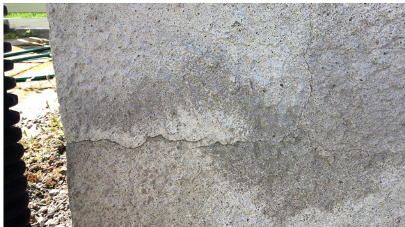
Skråriss i ringmur.
