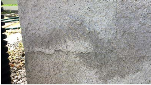
Skråriss i ringmur.
