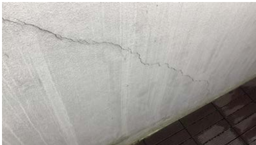
Skråriss i forstøtningsmur.
