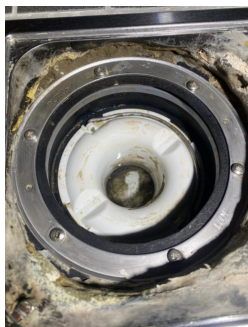
Sluk med synlig membran under klemring.
