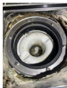
Sluk med synlig membran under klemring.
