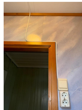
Dårlig klamret ledning (antagelig selvgjort) på toalettrom
