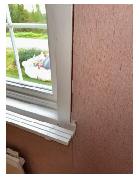
Punkter med mangelfull tapet etter skifte av vinduer
