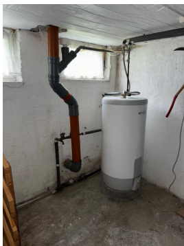
Avløpsrør fra toalettrom. Luftning avsluttet i kjeller med Durgo ventil.
