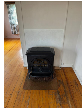
Lakkert tregulv i stue med slitte overflater.
