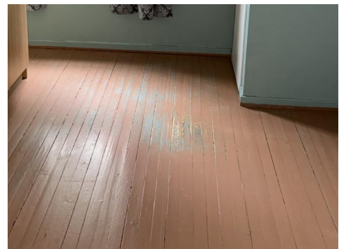
Malte tregulv med forhøyet slitasje på oveflater
