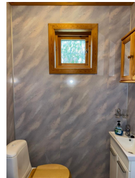
Ingen ventilering eller tilluft i rommet utover åpning av vindu.
