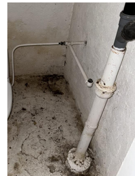
Gamle støpejernrør ut i dekke på toalettrom.
