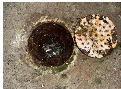
Gamle rustne støpejernsluk i kjeller
