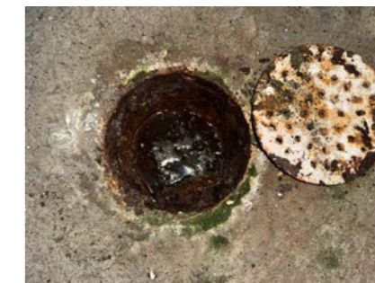
Gamle rustne støpejernsluk i kjeller
