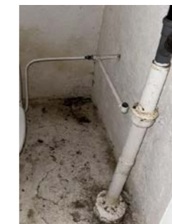
Gamle støpejernrør ut i dekke på toalettrom.
