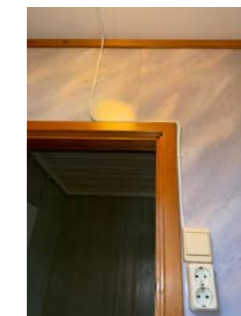
Dårlig klamret ledning (antagelig selvgjort) på toalettrom
