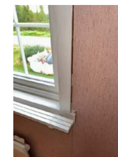
Punkter med mangelfull tapet etter skifte av vinduer
