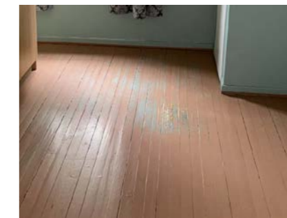
Malte tregulv med forhøyet slitasje på overflater
