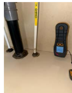
Oppsvulmet skapbunn med forhøyede fuktnivåer
