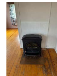
Lakkert tregulv i stue med slitte overflater.
