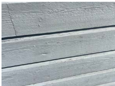
Mindre slitasje kledning på vegg mot vest
