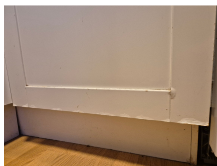
Fuktsveller på fronter.
