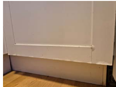
Fuktsveller på fronter.
