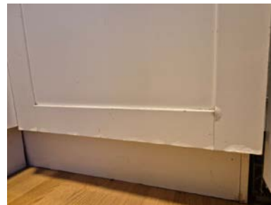
Fuktsveller på fronter.
