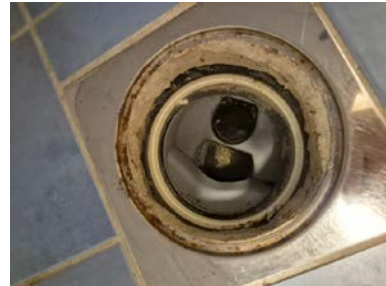
Sluk under innredning.
