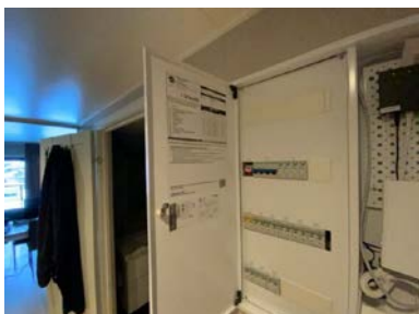
El-anlegg med automatsikringer.
