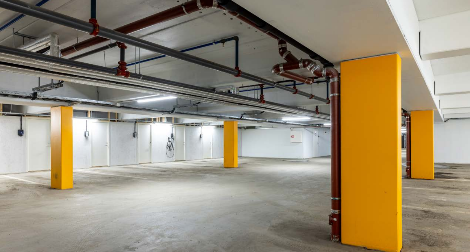
Oppvarmet P-kjeller med egen avsatt parkeringsplass. Montert elbil-lader.
