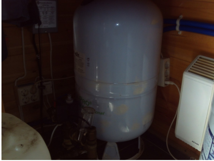
Trykktank i utvendig bod.
