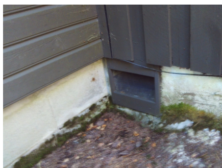
Større gode ventiler i ringmur.
