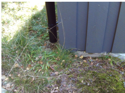
Kledningenb nær bakkenivå på ene yterhjørne.
