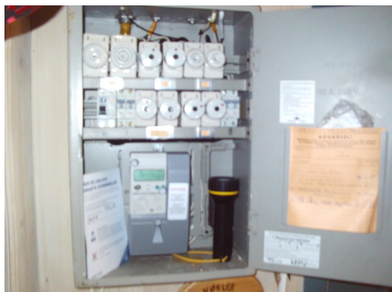
Sikringsskapet er plassert i gangen.
