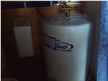
Bereider er plassert i utvendig bod
