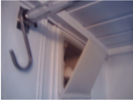
Ventil i ytterveggen
