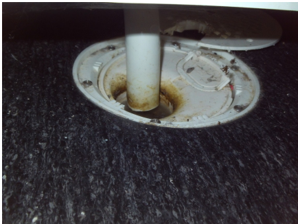
Sluk under dusjkabinett.
