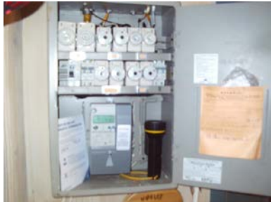
Sikringsskapet er plassert i gangen.
