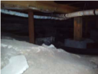
Lav høyde i deler av bakkant av hytta
