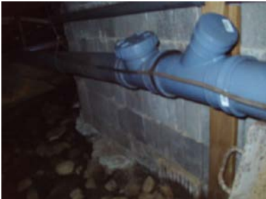
Plastrør med stakeluke.
