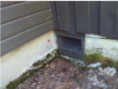
Større gode ventiler i ringmur.
