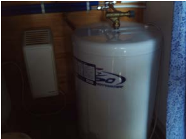
Bereder er plassert i utvendig bod
