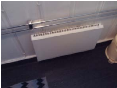
Panelovn på veggen.
