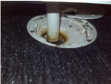
Sluk under dusjkabinett.
