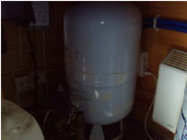
Trykktank i utvendig bod.
