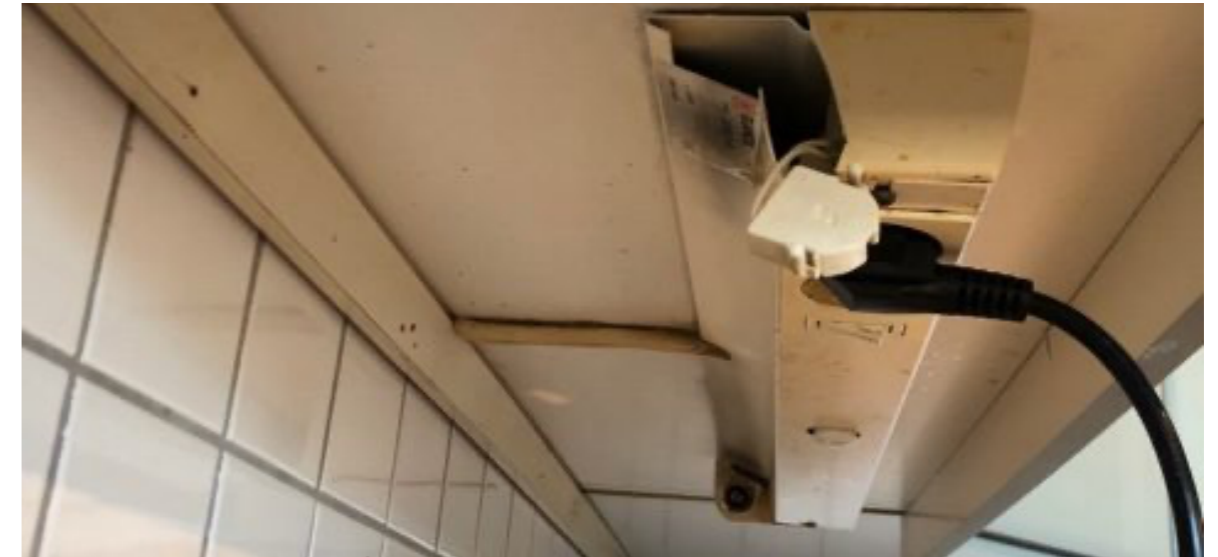
Bilde 1 Tilkobling er løs og armatur er ikke i forsvarlig tilstand. Side deksel er knekt og tilkobling henger løst.
