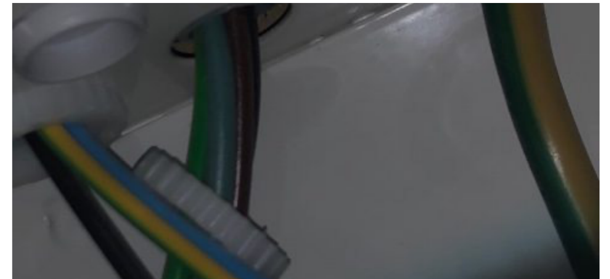
Bilde 1 Gjennomføring som er avbildet er defekt/ødelagt
