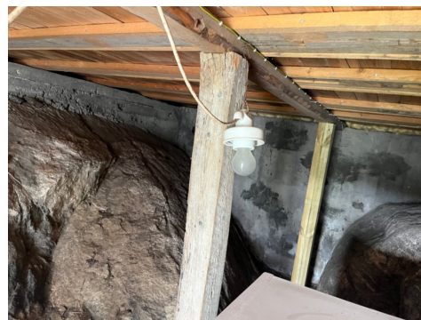
Kryperom under stue.
