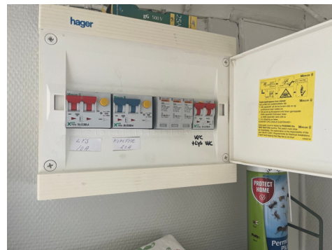
El-skap på kjøkken.
