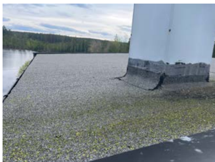
Det er manglende stigeledd til pipe.
