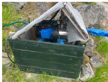
Vannpumpe er plassert nede ved veien.
