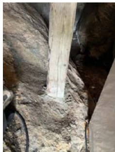
Tresøyler ned på grunn må holdes under oppsikt.
