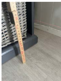
Måling med laser viste skjevheter på gulv.
