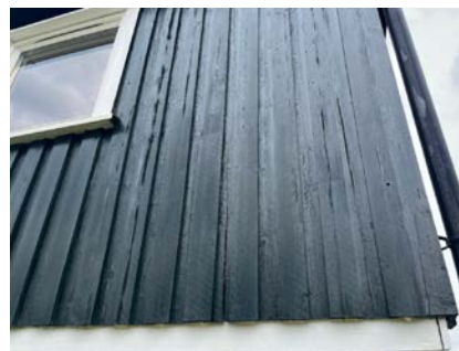
Flere kledningsbord har sprekker.
