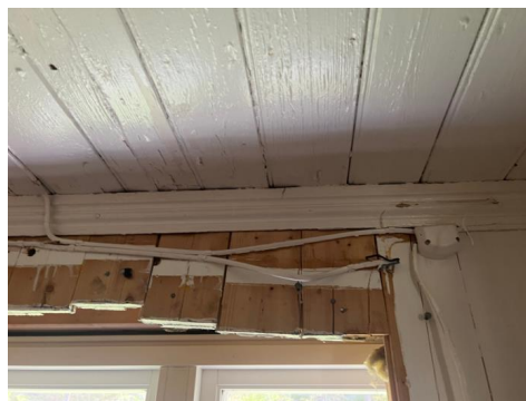
Det er noen løse kabler + uisolerte kabler i gammel del.
