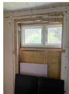
Viser uferdige arbeider rundt vinduer i gammel del.
