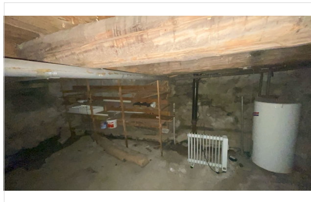
Bereder plassert i kjeller. Vanninnsig/fuktbelastning i kjeller.
