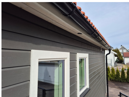
Mangler vannbrett over vinduer.
