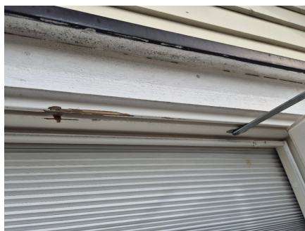
Noe skader/sår på terrassedør i 2. etg.
