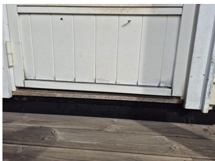
Værslitt terrassedør i 1. etg.
