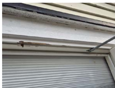
Noe skader/sår på terrassedør i 2. etg.
