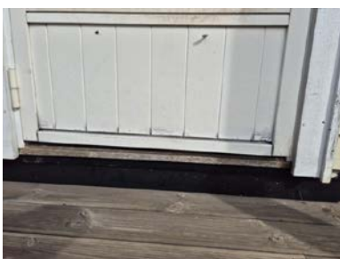
Værslitt terrassedør i 1. etg.
