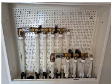
Rørskap til bad i 2. etg.
