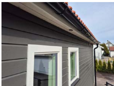
Mangler vannbrett over vinduer.
