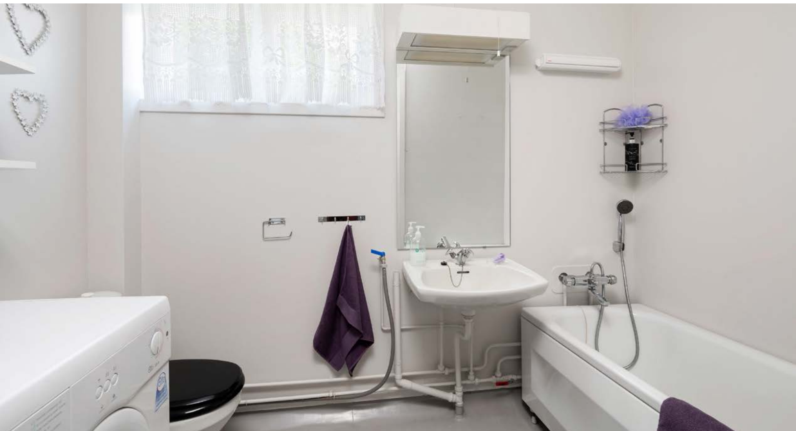
Eldre bad i 1. etasje som er antatt bygget på slutten av 1960-tallet. Baderommet har fått TG3 i tilstandsrapporten og det anbefales at rommet totalrenoveres.
