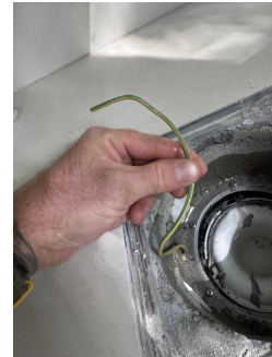
Jordingskabelen var ikke festet til slukristen på befaringdagen.
