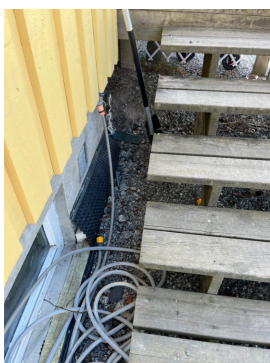
Manglende rekkverk/stor åpning
