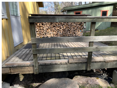
Manglende rekkverk, store åpninger.
