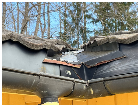
Rust på beslag.
