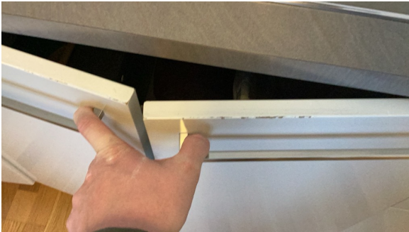
Svelleskader på innredning.
