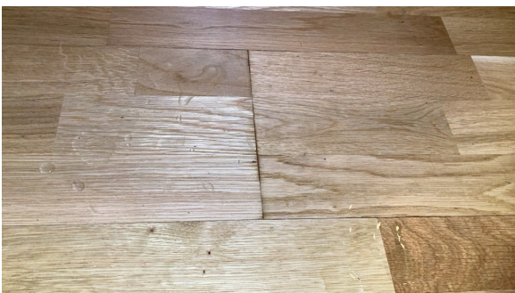
Misfarging i laminatskjøt i gang.
