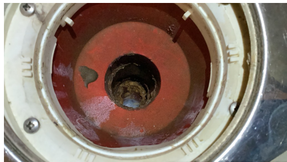
Rust i sluk registrert.
