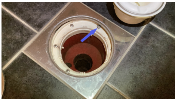
Skrue i sluk er ikke skrudd helt ned.
