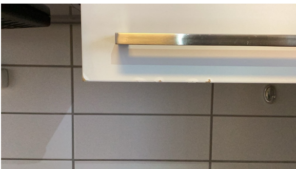
Svelleskader på innredning.
