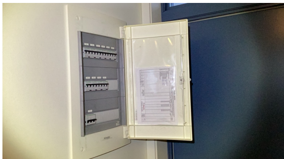
Sikringsskap i gang.
