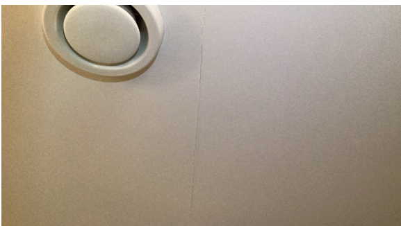
Sprekker/riss i enkelte gips overflater rundt om i boligen.
