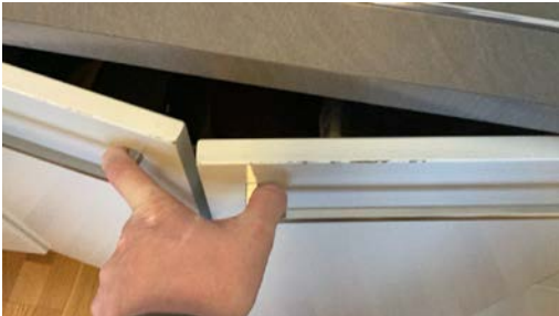
Svelleskader på innredning.
