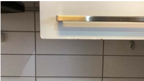
Svelleskader på innredning.
