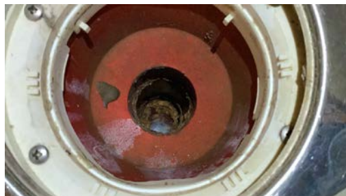
Rust i sluk registrert.
