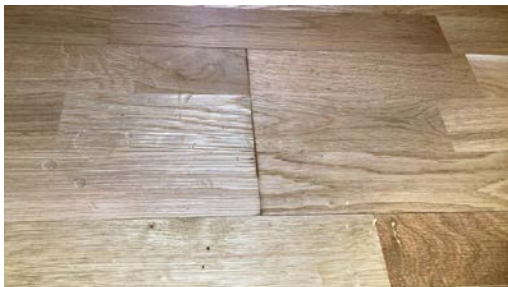
Misfarging i laminatskjøt i gang.
