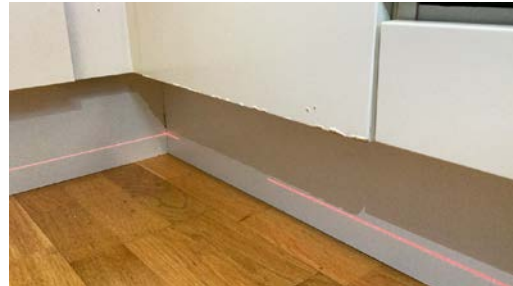
Svelleskader på innredning.
