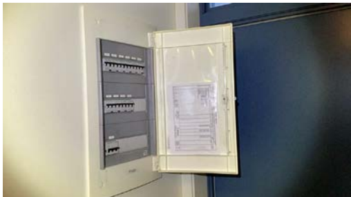
Sikringskap i gang.
