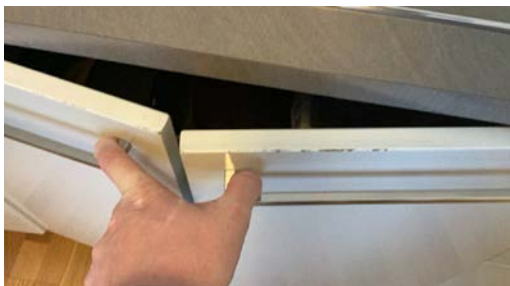
Svelleskader på innredning.
