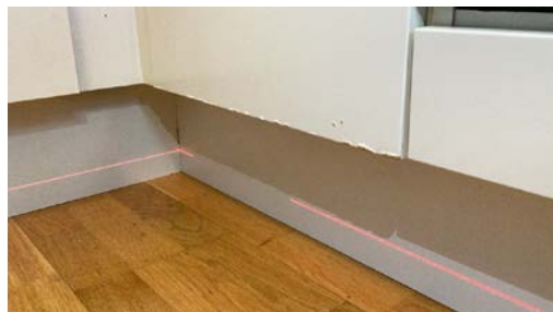
Svelleskader på innredning.
