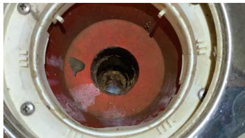
Rust i sluk registrert.
