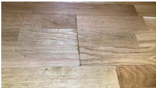
Misfarging i laminatskjøt i gang.
