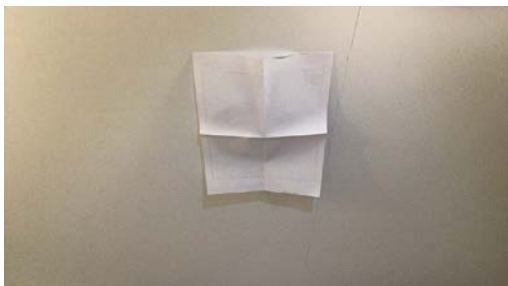
Avtrekksvifte er testet som beskrevet i NS3600.
