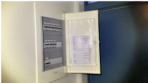
Sikringskap i gang.
